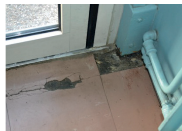
▶ Dalles de sol (colle et matière amiantée) dégradées
