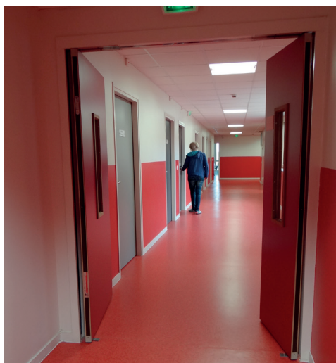
Porte coupe-feu de recoupement (couloir)
